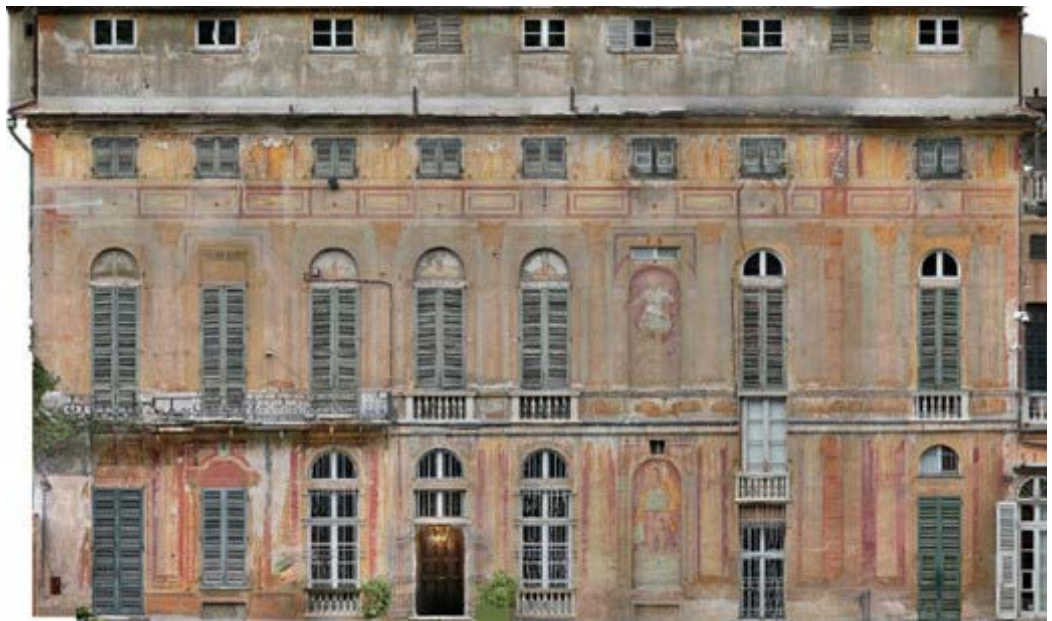
Fig. 9. Rilievo aerofotogrammetrico da drone della facciata secondaria prospiciente il giardino. Elaborazione delle autrici.
