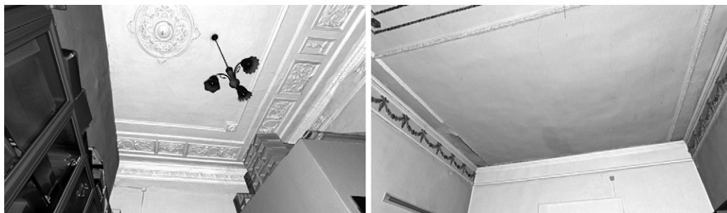
Fig. 9. Decorazioni in stucco di ambienti del piano terra interrotte dall'introduzione di pareti divisorie di più recente edificazione. Viste del modello a nuvola di punti. Elaborazione di CHM_lab.
