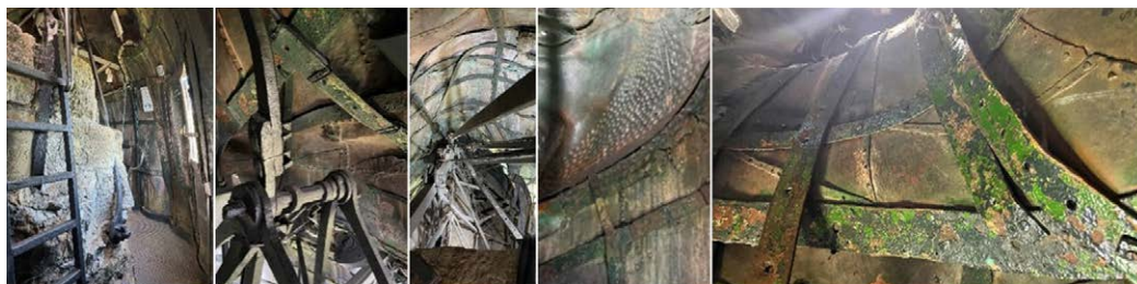
Fig. 3. Alcune foto d'insieme e di dettaglio dell'interno della testa, con evidenza la struttura metallica di sostegno della "gabbia" metallica cui sono ancorate le lastre in rame. Elaborazione degli autori.
