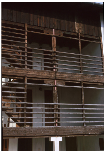
Esempio di casa a ballatoio su pilastri lignei delle Prealpi Carniche. Particolare del primo pilastro di appoggio al piano terra in pietra per ridurre i fenomeni di degrado del legno a contatto con il terreno
