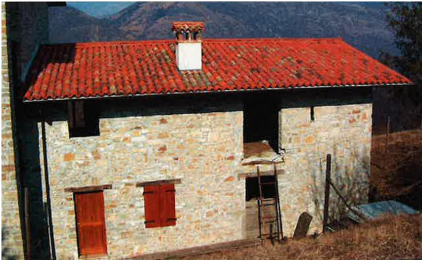
Fig. 26 - Foto degli interventi post-sisma in Friuli-Venezia Giulia, esempio di paramento murario esterno, lesionato e recuperato con il metodo cuci-scuci
