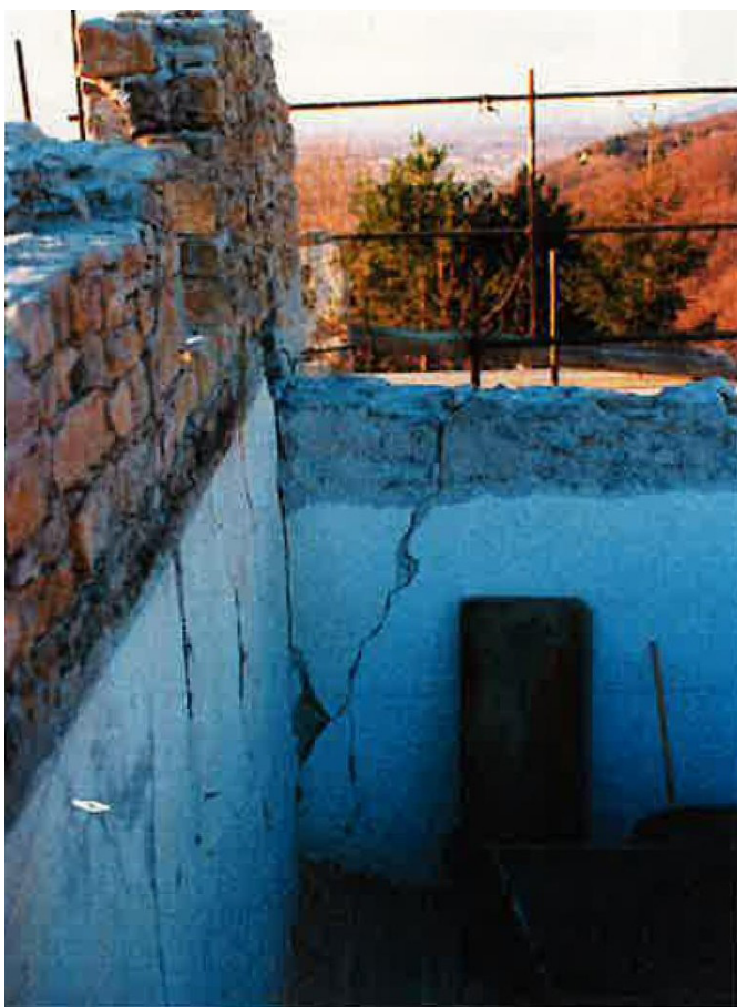
Fig. 28 - Foto di una lesione passante isolata in un cantiere della ricostruzione in Friuli
