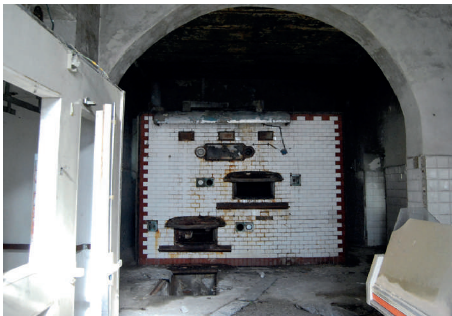
Fig. 11 – Aversa, Ospedale Psichiatrico “Santa Maria Maddalena”, la cucina con il forno del panificio nella Casa Centrale [foto di M. D’Aprile, 2019].
