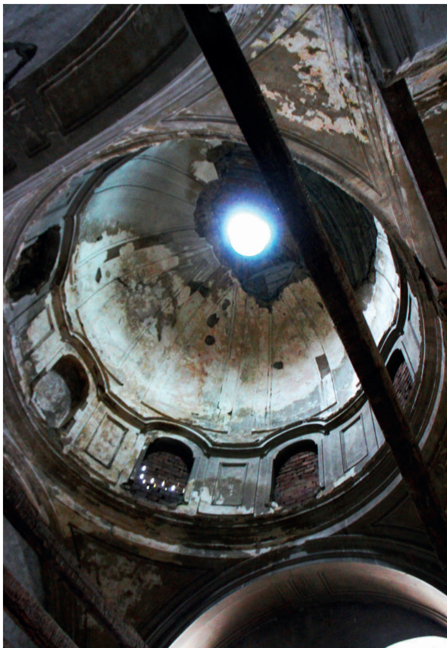
Fig. 62 – Aversa, chiesa di Santa Maria di Montevergine, già parte della sezione distaccata femminile delle Reali Case de' Matti. Intradosso della cupola [foto di R. Serraglio, 2024].
