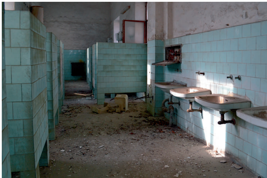
Fig. 10 – Aversa, Ospedale Psichiatrico “Santa Maria Maddalena”, servizi igienici nella Casa Centrale [foto di E. Manzo, 2012].
