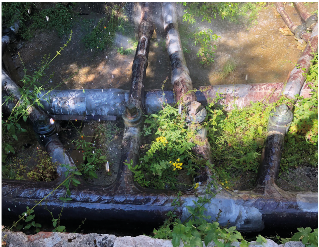
Fig. 12. Tuberías originales del siglo XVIII en servicio en las fuentes de La Granja (fotografía de los autores).
