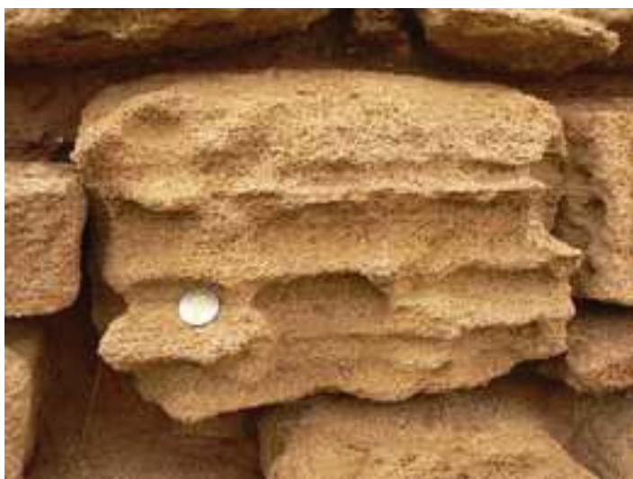
Fig. 08 : Alvéolisation ; la surface des blocs de calcarénite montre des creux relativement profonds qui se rejoignent
