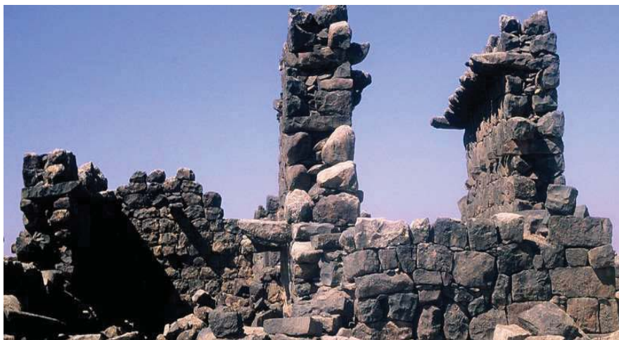
Fig. 03 : Parfois, on peut trouver des planchers doubles ou des remaniements qui sont des traces claires de travaux de révision et de maintenance au fil du temps. Seulement dans de rares cas, des morceaux en bois ont été trouvés pour soutenir les éléments basaltiques
