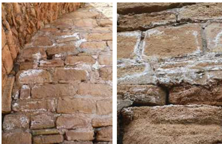
Fig. 05 : L'altération saline se développe sous forme d'encroutements sur le pourtour des pierres jointoyées par du mortier à base de ciment. Fig. 06 : Détails des efflorescences et encroutement salins sur la calcarénite de Salé, à l'interface pierre-mortier
