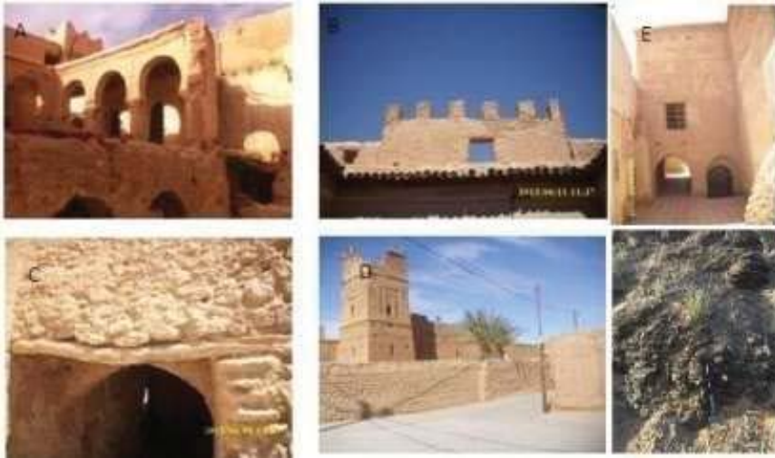
Fig. 04 : Ksar, quelques exemples d'une maison détériorée du Moussani, des passages sous forme d'arcades entre des ilots (construits afin de faciliter la circulation en zone aride)
