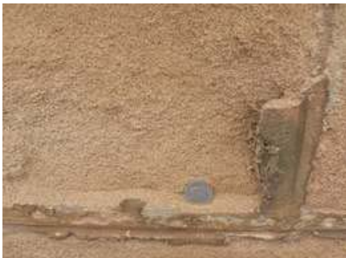
Fig. 07 : Désagrégation sableuse d'un bloc de calcarénite, conséquence de l'utilisation d'un mortier de ciment dur. La roche s'est creusée en une seule et unique alvéole.
