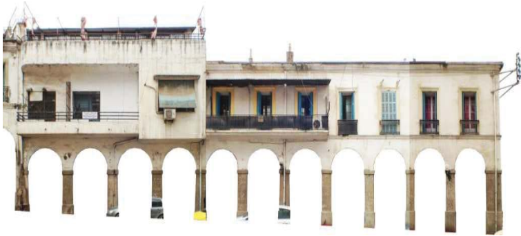
Fig. 11 : La façade qui donne sur la rue Didouche Mourad avant l'opération Source : Rapport du constat mesure d'urgence, Groupement CTC-EST/AQUIDOS Réhabilitation Intégrale du Boulevard Didouche Mourad d'Skikda CAHIER DE CHARGES DE MESURES D'URGENCE. Ilot 14. 07 JUIN 2015. Skikda
