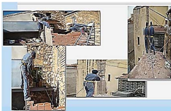
Fig. 06 : L'immeuble N°54 pendant les travaux. Source: BET privé. Op. Cit. Réalisation : Auteur
