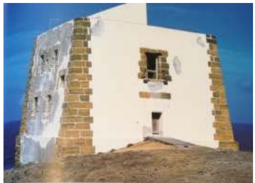
Fig. 12 : Torre dello Spalmatore, Ustica (PA). Le nouveau plâtre de béton est très dégradé
