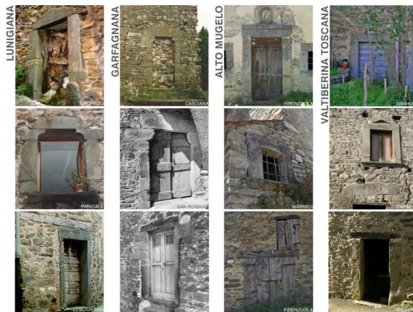
Fig.4 – Architravi nelle quattro aree di studio – Fonte: archivio Pierotti Ulivieri (elaborazione di Landi S.)
