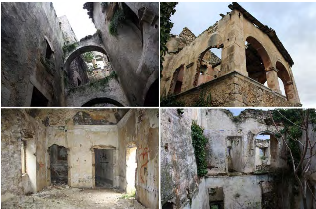
Fig. 4 – Navelli, Palazzo Onofri: foto dello stato di fatto, anno 2014 - Fonte: foto di Angela Desideri
