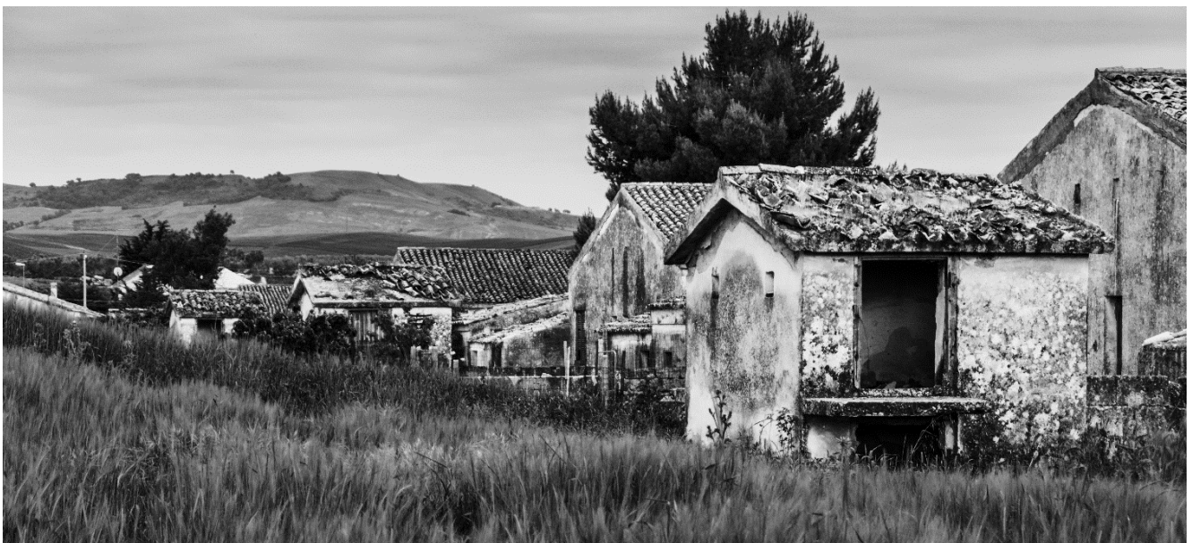
Fig. 5 – Facciate esterne fortemente degradate
