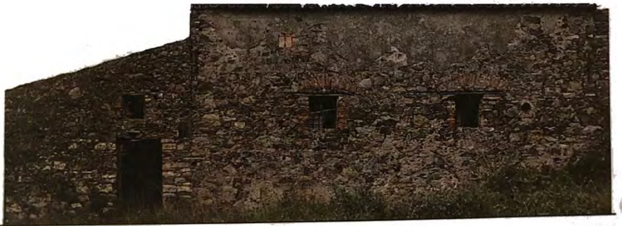
Fig.6 – Rilievo materico e fotoraddrizzamento – Fonte: Progetto di restauro architettonico per alcuni jazzi presso Vibonati (SA), M. Fierro, A. Messina, O. Nicodemo, Laboratorio di restauro architettonico, prof. R. Picone a.a. 2016-17
