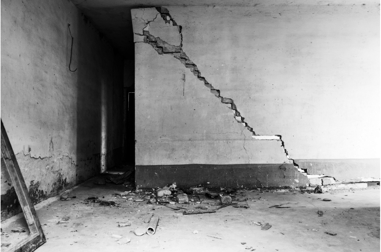
Fig. 4 – Esempio emblematico della tipologia di fessurazioni rilevate
