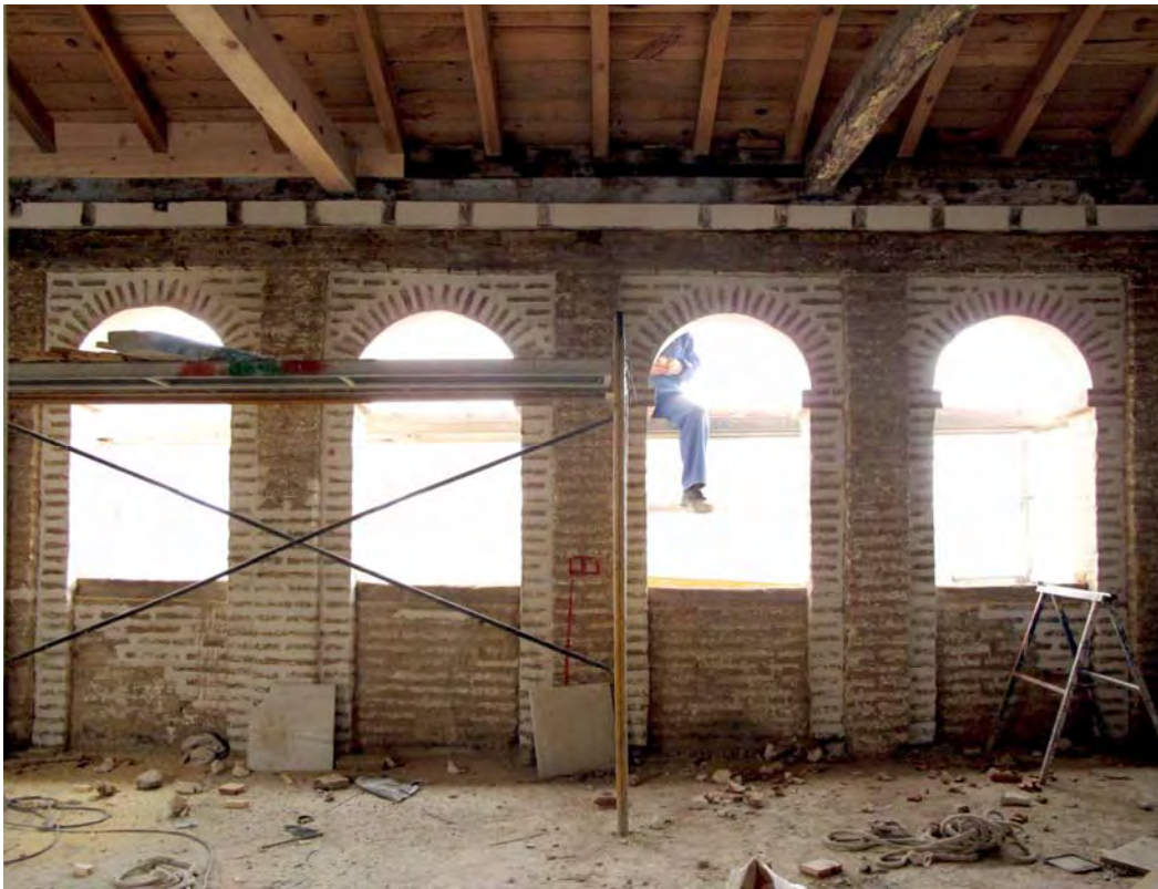
Fig. 9 – Casa Zayas. Obras de restauración de la fachada. - Source: photo of the authors
