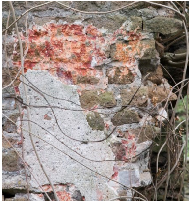
Fig. 7. Ninfa: tracce cromatiche su paramento murario esistente.
