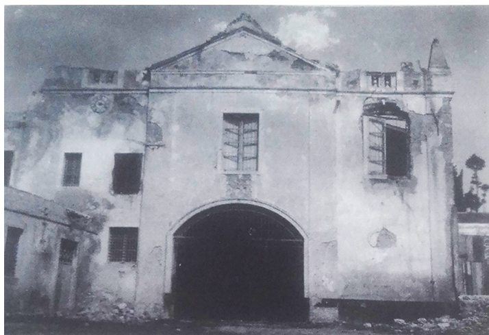
Fig. 2. Prospetto della Chiesa dei Cappuccini dopo il terremoto del 1908 (in G. Molonia, Opere d'arte dei Cappuccini di Messina , a cura di G. Lipari, Messina 2015, pag. 239).
