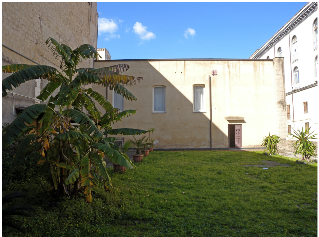
Fig. 2. Porzione di chiostro ancora esistente, interrotta dalla realizzazione del muro tufaceo: un unico fronte rimane integro mentre i due bracci laterali sono interrotti.
