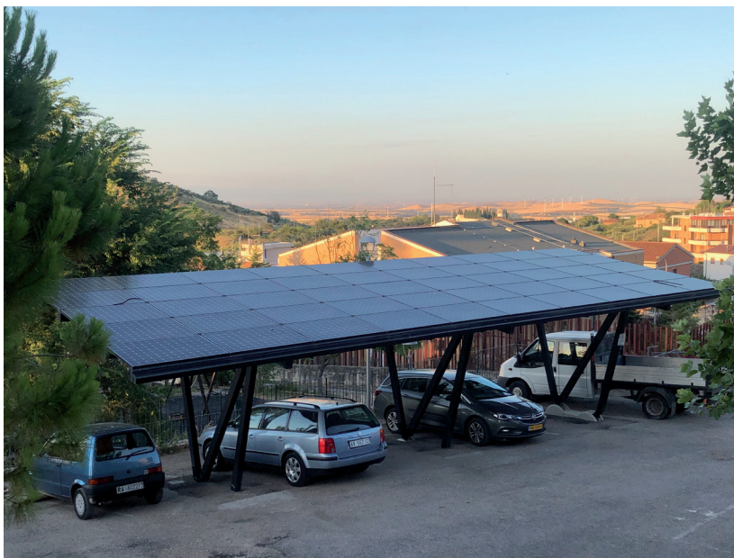
Figg. 5.11 e 5.12 - Biccari, Alcuni impianti fotovoltaici che rientreranno nella CER. Fonte: autori
