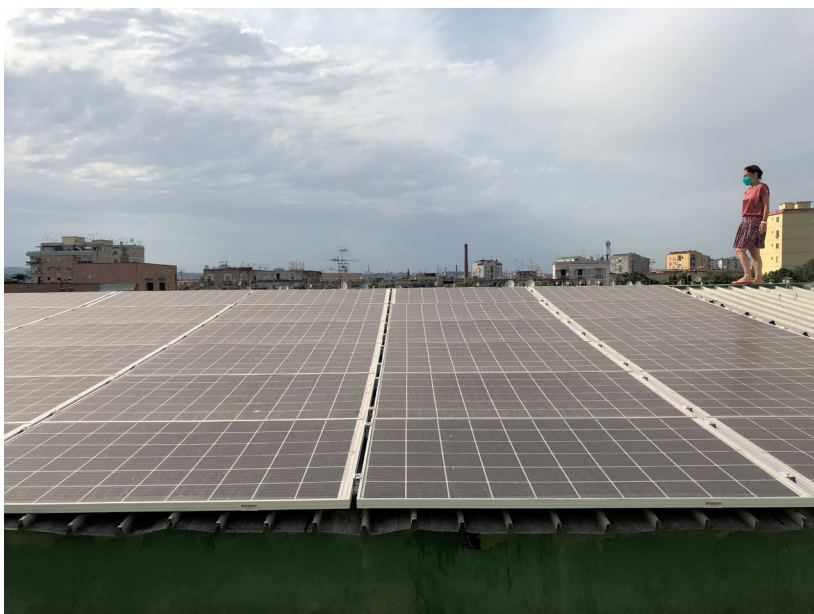
Figg. 5.7 e 5.8 - Fondazione Famiglia di Maria, patio e impianto fotovoltaico installato. Fonte: autori
