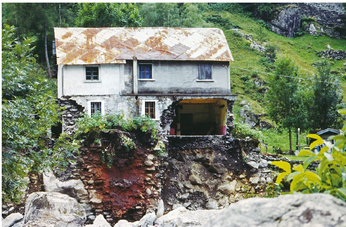
Figura 28 Vedello. Privativa Tavelli lesionata dall'alluvione del 1987. Al di sotto della struttura sono visibili i probabili resti dell'ottocentesco forno fusorio, emersi in seguito all'esonazione del torrente Caronno (foto Marino Amonini).
