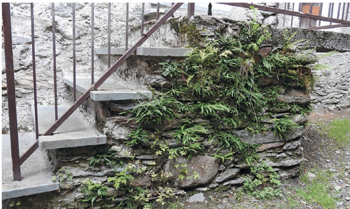
Figura 49. A Vassalini una recente scala poggia su un antico manufatto in pietra. È evidente la ricca vegetazione sul manufatto antico e la completa assenza di piante sui gradini recentemente costruiti.
