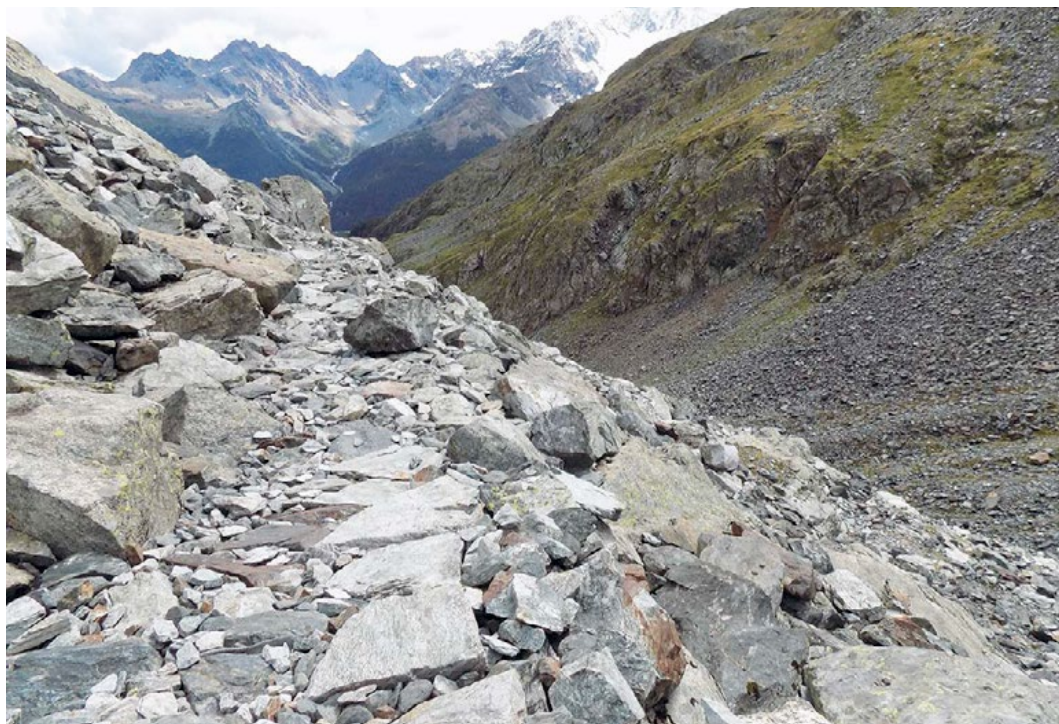
Figura 23. L'attraversamento di ghiaioni necessita di una perizia costruttiva del sedime stradale e di una manutenzione costante.
