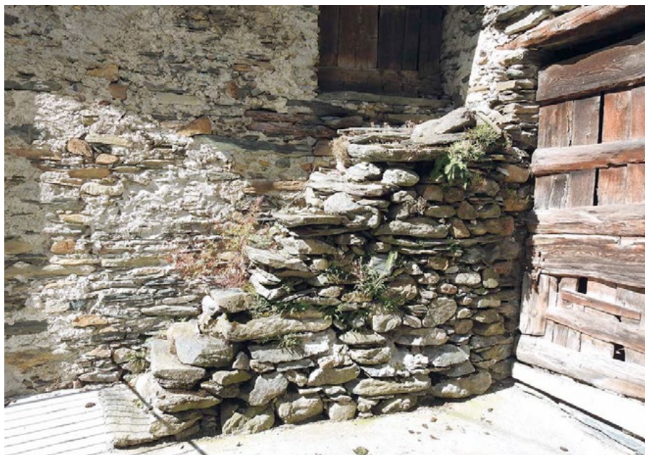
Figura 2. Dettaglio dell'accesso rialzato ad un'abitazione realizzato utilizzando elementi di provenienza detritica, fluviale o glaciale, come suggerisce la forma e l'irregolarità degli elementi, che si riflette sulla tessitura muraria. Le pedate sono realizzate con elementi monolitici planari, lisci ma al contempo scabri per la sicurezza di chi sale o scende le scale.
