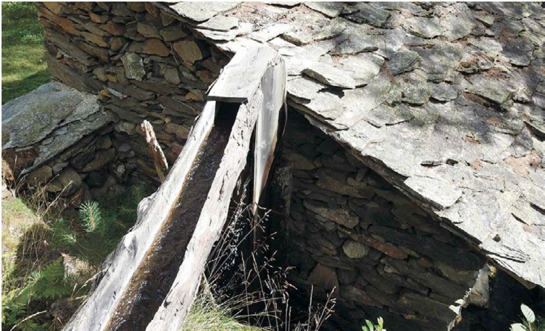
Figura 63. L'acqua del canale viene condotta sopra la ruota del mulino del tornio mediante una canaletta in legno.
