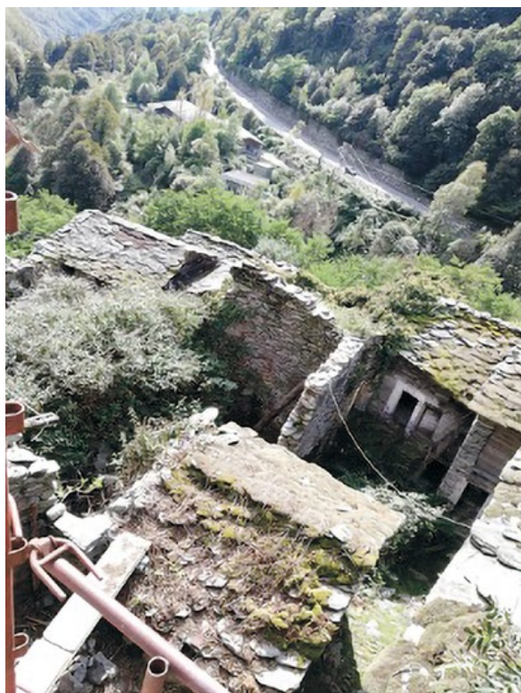
Figura 5. Scilironi; zona difficilmente recuperabile (particelle 637, 641, 642, 643, 644, 651, 652, 1070, 1073 nella mappa catastale). Si tratta sostanzialmente di ruderi inabitabili da conservare e mettere in sicurezza.
