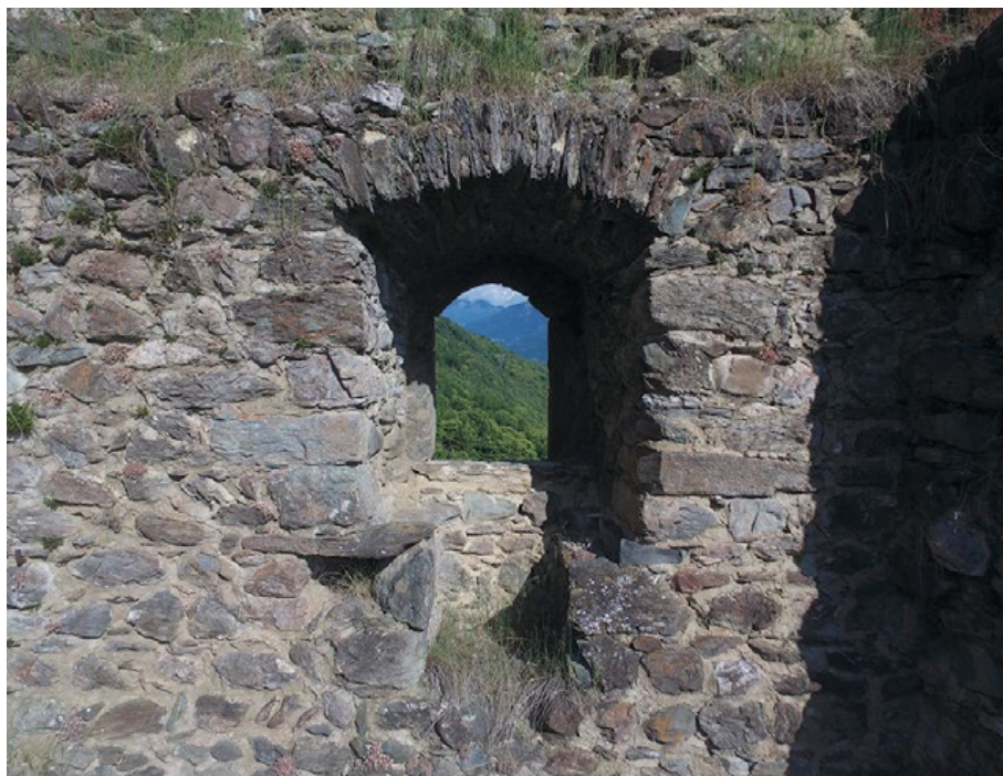
Figura 6. La finestra con seduta del penultimo piano della torre, vista da drone.
