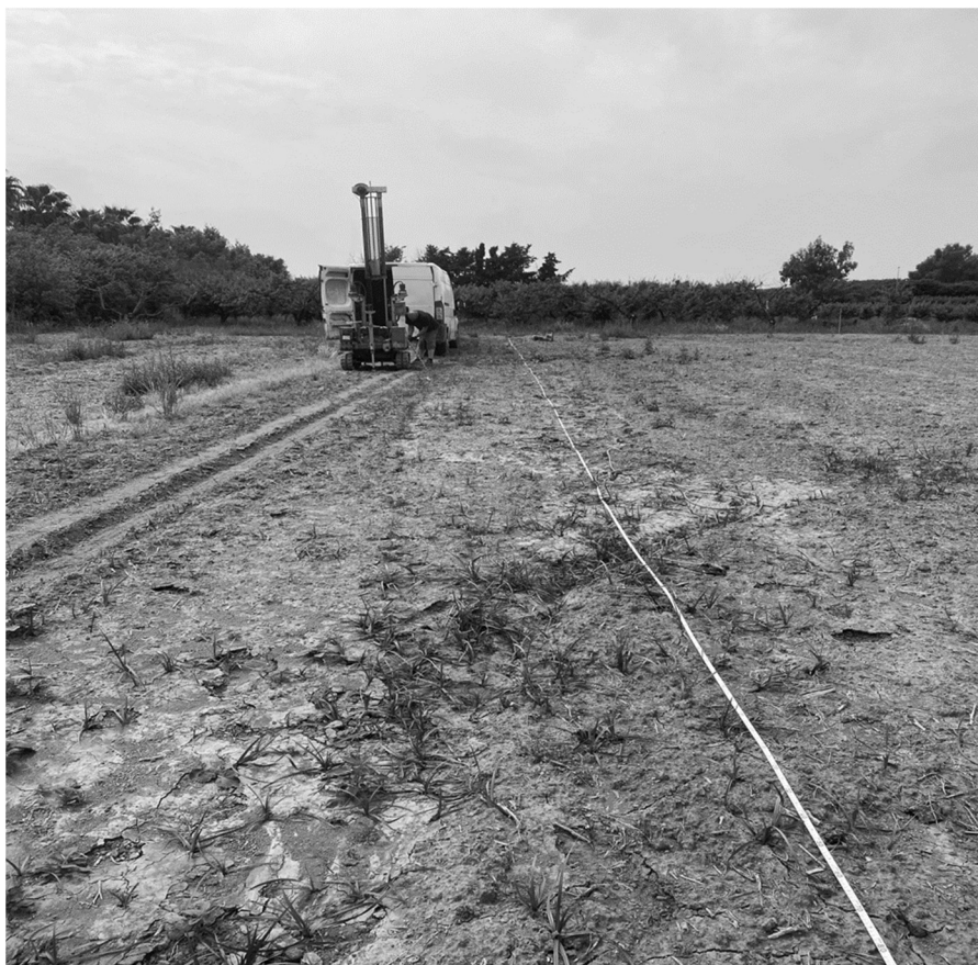
Fig. 3 – Foto sul fondo durante la prova geologica necessaria ai fini dell'installazione della serra
